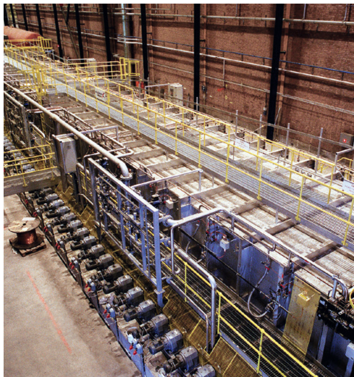
Ohřívací pec se systémem spalování kyslíkem REBOX® s keramickými kyslíkovými hořáky a řídicím systémem Linde
